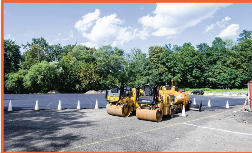
מען פארברייטערט דעם פארקינג לאט ביים וויזשניצער ביה"ח אין מאנסי, צוליב דעם ריבו עם ביי די ציוני הצדיקים הטמונים שם
